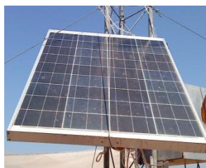
Figura 6.6. Panel solar conectado, uno en cada torre de acero para recargar las baterías durante el día.
